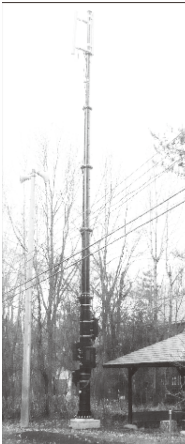
キリン公園（花の街）に設置された電波塔。 他に森の街と鳥の街の間に1塔設置済みで虹の街は地権者と用地交渉中。
